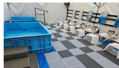
仮設入浴設備
