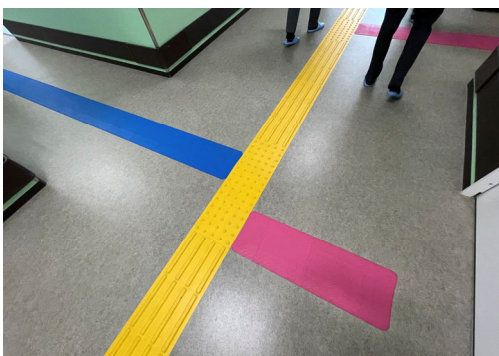
男女トイレを分別できる 誘導ブロック
