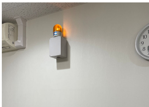
宿泊室に設置された インターホンが鳴ると光るサイレン
