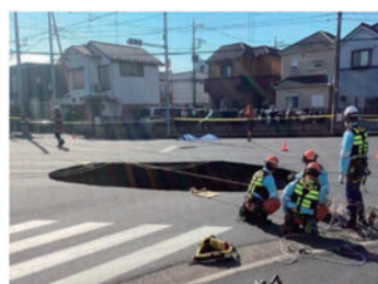
写真：道路陥没の事例
