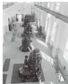
松重ポンプ所の内部
