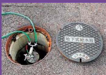
Vòi nước dưới lòng đất (Khi mở nắp hố sẽ thấy có van nước được lắp đặt bên trong.)
