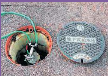
Underground hydrant (buksan ang takip ng manhole para magamit ang gripo)
