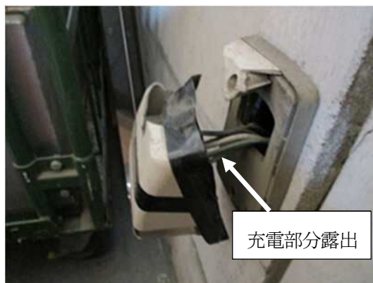
コンセント破損状況
