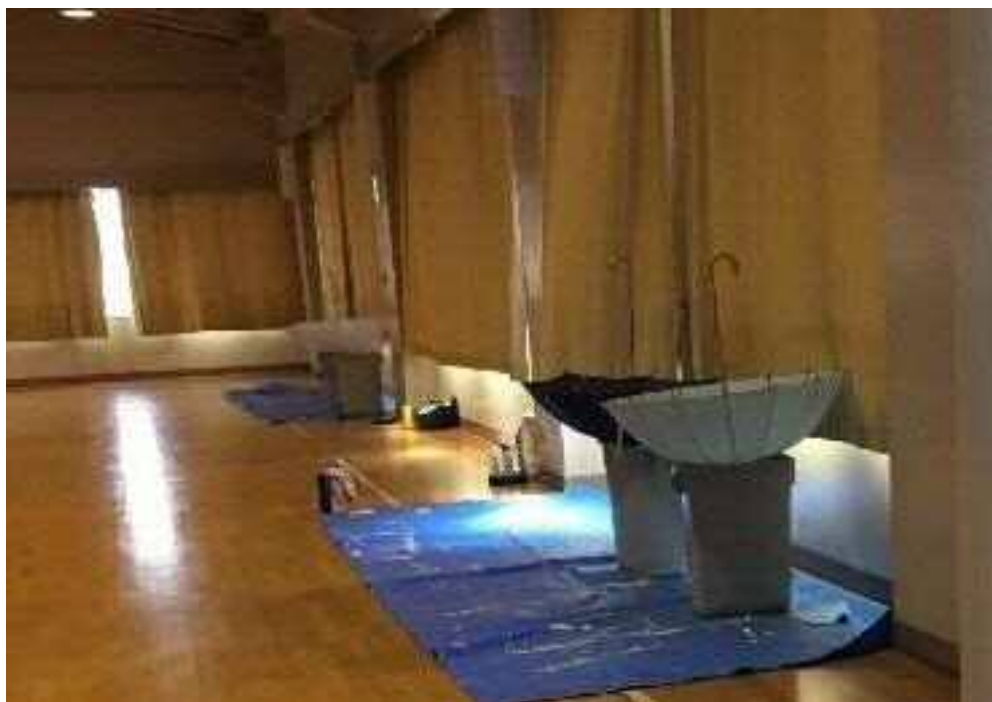
格技場雨漏り
