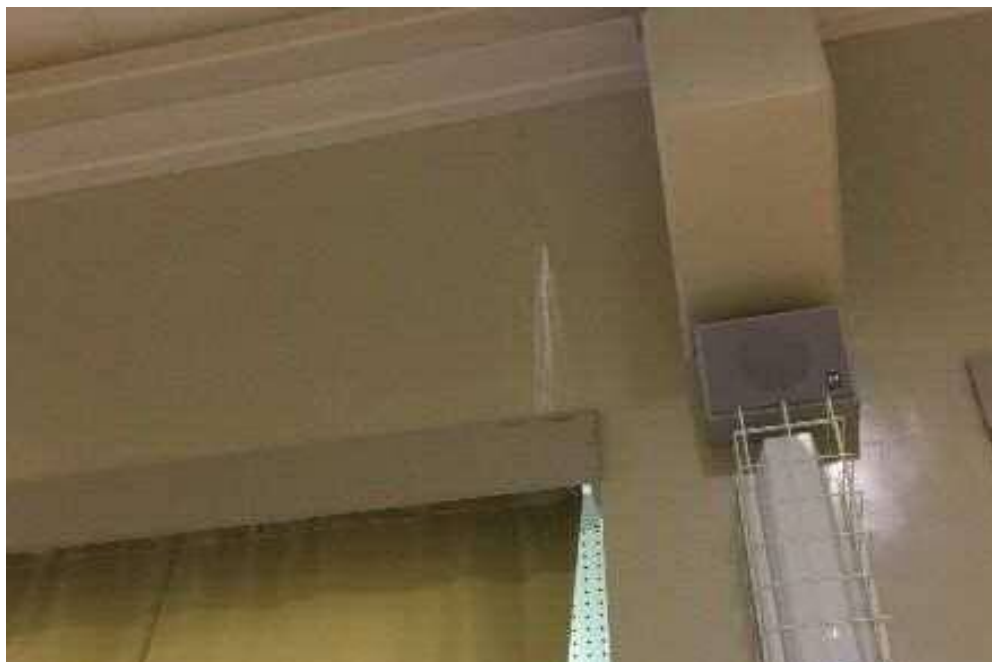
格技場ひび割れ
