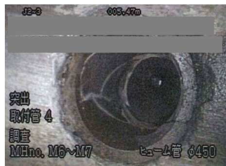
取付管破損状況
