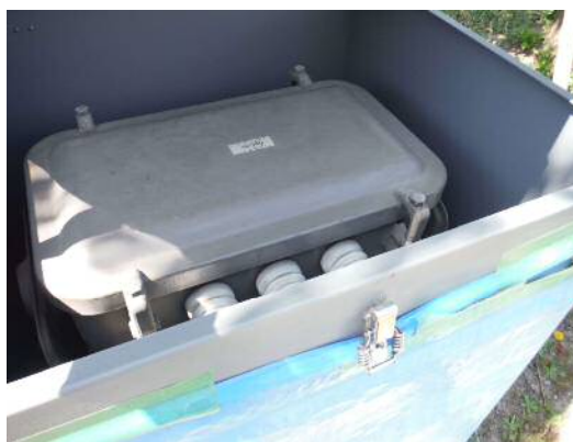
保管容器内の P C B 廃棄物 (変圧器)
