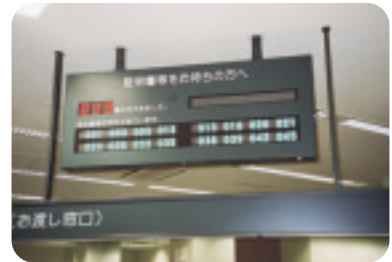
●交付呼び出し番号自動表示装置(熱田区役所)
