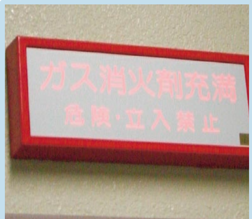
⑥室内への立入を禁止する放出表示灯が点灯又は点滅する
