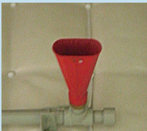
⑤噴射ヘッドからガス消火剤が放出される
