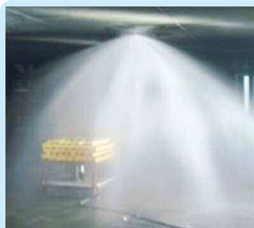
② 専用ポンプが起動し、消火が行われる
