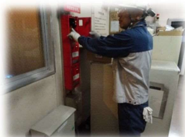
不活性ガス消火設備 操作訓練
