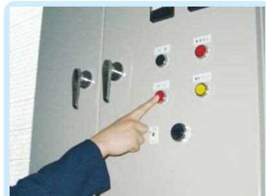
② ポンプ制御盤 (ポンプ室等) の 停止操作を行う
