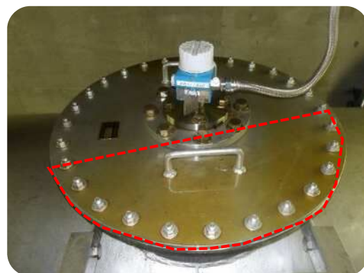
↑ 重油が付着したタンク上部(点線部分)
