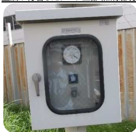
↑ 故障していた油量計
