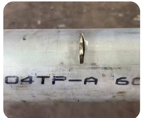
↑ 誤って破損させた危険物配管
