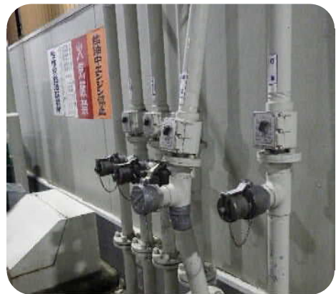
↑ 破損した通気管
