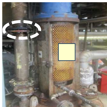
↑ 漏洩フランジ部分
