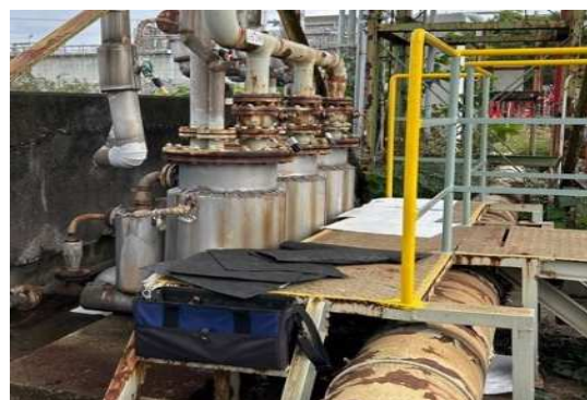
↑ 危険物の漏洩があった水封槽
