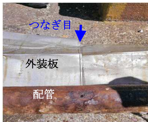
↑ 保温措置部と配管
