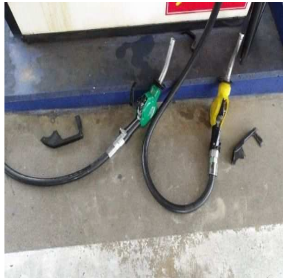
↑ 破損したノズル
