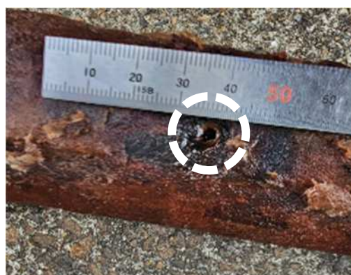
↑ 配管腐食部分
