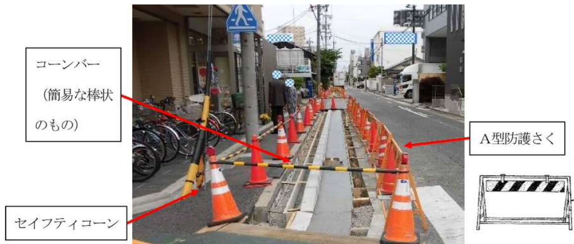
歩道上にA型防護さくが設置されていない状況
