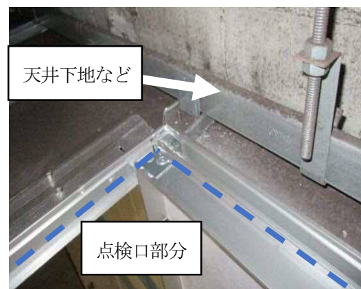
固定されていない点検口
