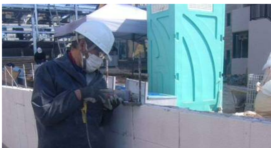
鉄筋が切断された状況
