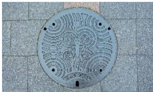
本市の下水道マンホールふた
