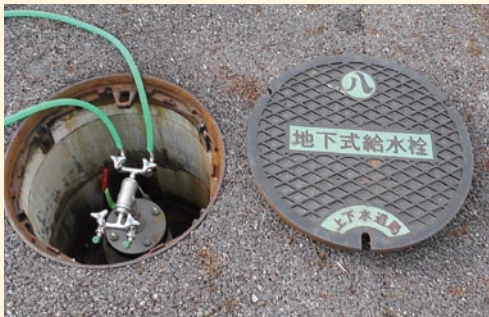
地下式給水栓
