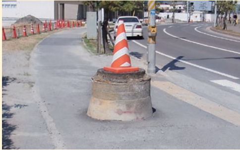
地盤の液状化で浮上した下水マンホール(千葉県浦安市)
