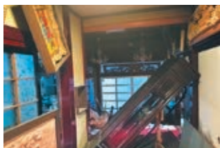
七尾市の被災家で 柱時計が倒れている様子
