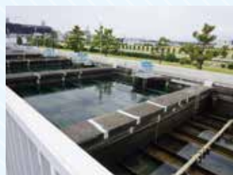
大治浄水場のろ過設備
