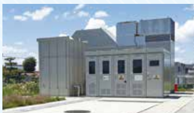
設置された非常用発電設備
