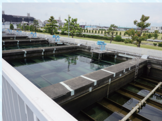
大治浄水場のろ過設備
