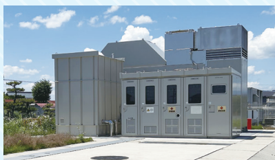
設置された非常用発電設備
