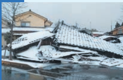
倒壊した家屋
