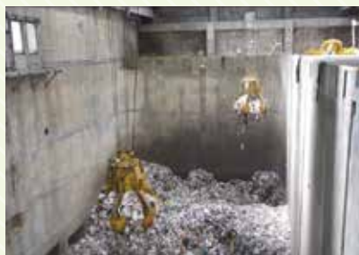
富田工場のごみピット
