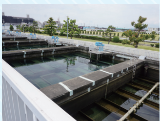
大治浄水場のろ過設備
