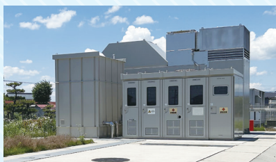
設置された非常用発電設備
