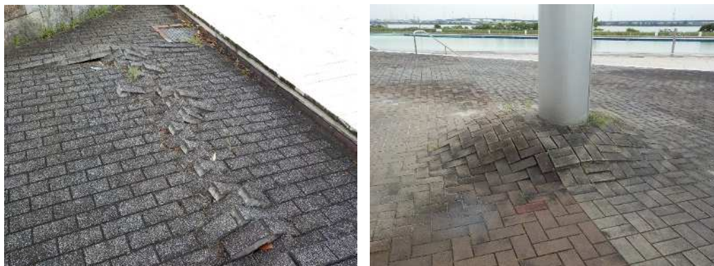
地盤沈下の影響（現況写真）
