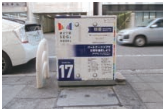
地上変圧器等への広告添加
