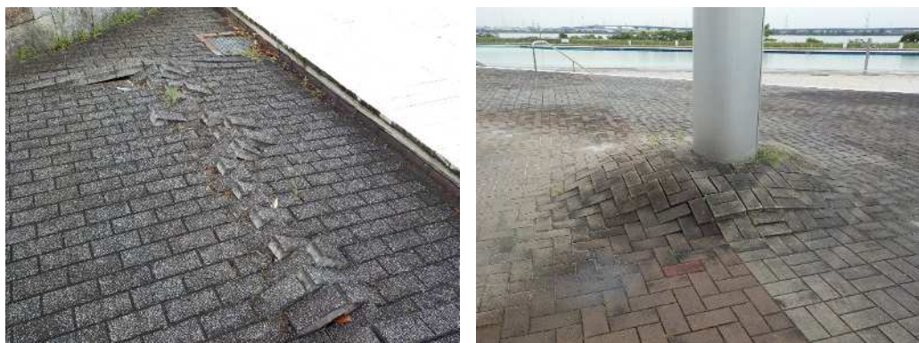
地盤沈下の影響(現況写真)
