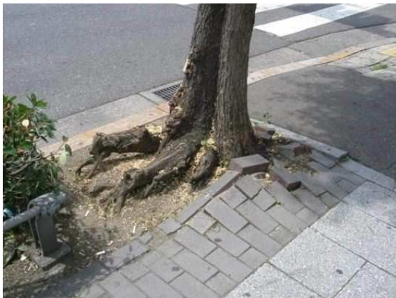
根上がりによる舗装ブロックの 浮き上がり（アメリカフウ）
