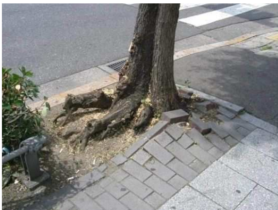
根上がりによる舗装ブロックの 浮き上がり（アメリカフウ）
