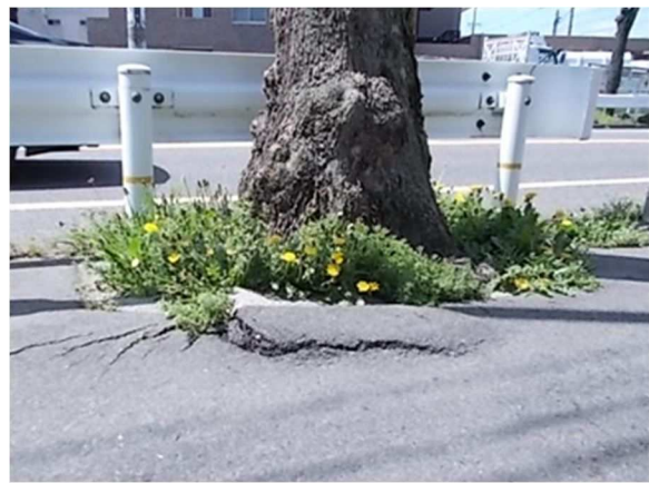
根上がりによる歩道の段差 （ナンキンハゼ）
