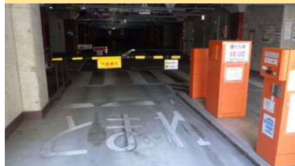
駐車場案内表示・管制設備
