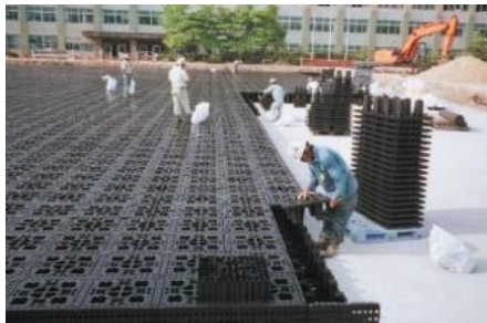
校庭に設置された貯留施設
