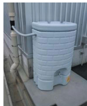
【写真18】雨水タンク
