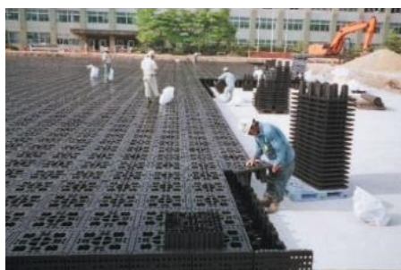
【写真13】校庭に設置された貯留施設
