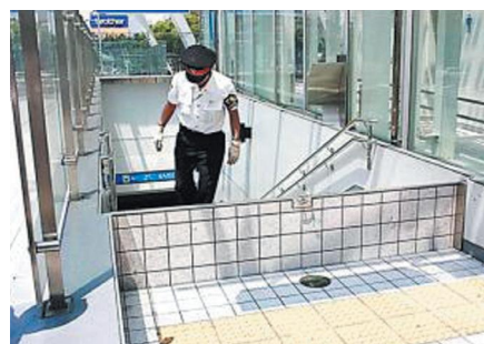
【写真20】地下鉄の起上方式止水板
