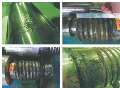
【写真10】ポンプ設備の老朽化
