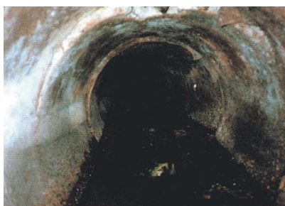
【写真4】老朽化した下水管
