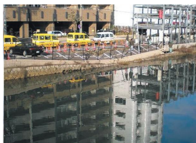
【写真5】老朽化護岸の崩壊
