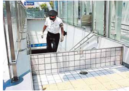
【写真20】地下鉄の起上方式止水板
