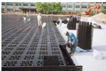
【写真13】校庭に設置された貯留施設
