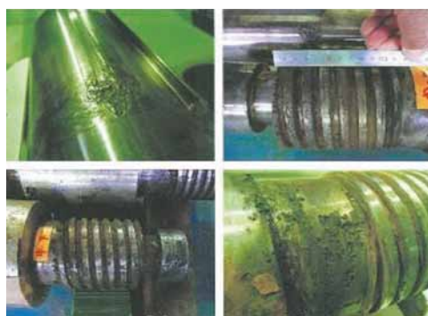
【写真10】ポンプ設備の老朽化
