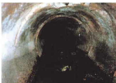
【写真4】老朽化した下水管
