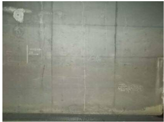
側壁のひびの様子
