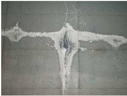
側壁の漏水・遊離石灰の様子
