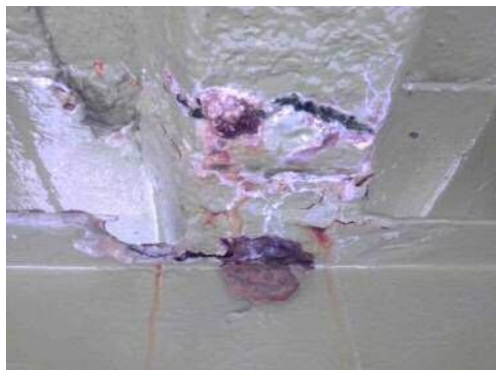
横桁、床板の腐食
