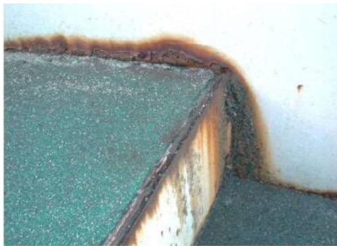
階段部の腐食
