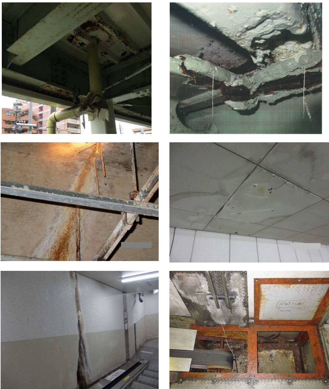
図表－3 損傷状況
