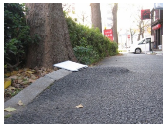
根上がりによる通行への支障
