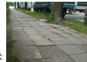
根上りの状況(修繕前)
