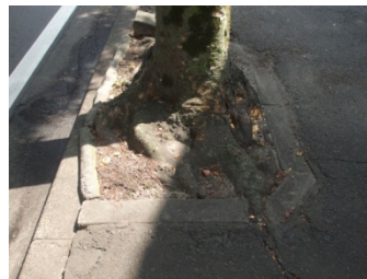
植ますに収まらない街路樹
