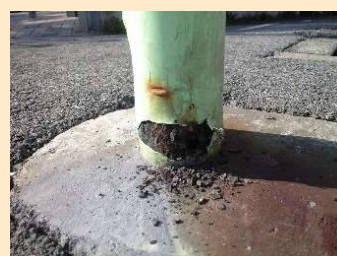
根元が腐食した街路灯
