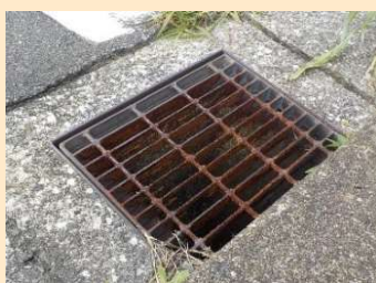
腐食したグレーチング蓋
