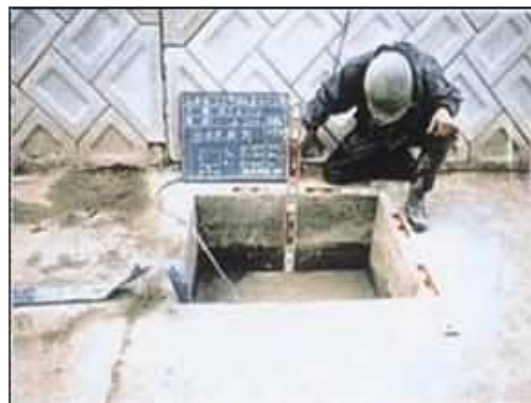
写真-4.8 防災用取水ピットの事例
