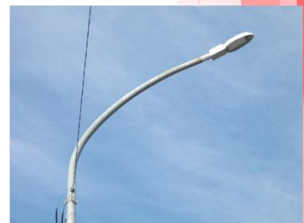
LED道路照明(リース)
