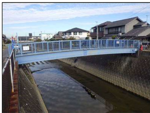
五月橋（修繕前）
