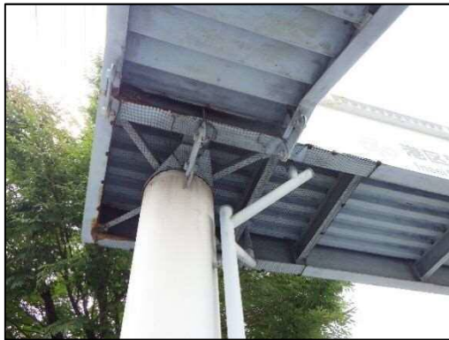
西稲永荘前横断歩道橋（修繕前）
