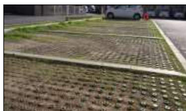
地先境界ブロックの際に段差あり
