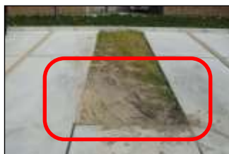
踏圧被害あり
