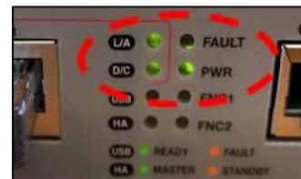
無線ルータが点灯
