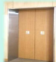
【エレベーター】
