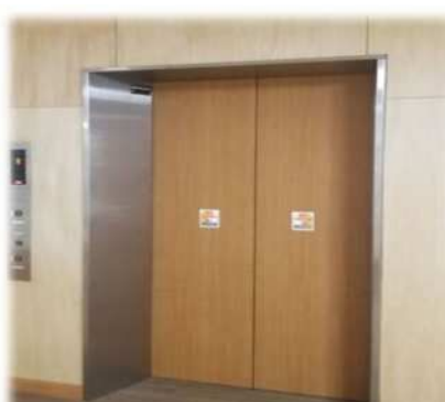
エレベーター
